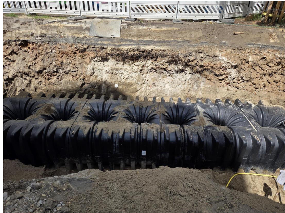
Regenwasserspeicherung (Garten Baumbachstraße/Eschengraben)
